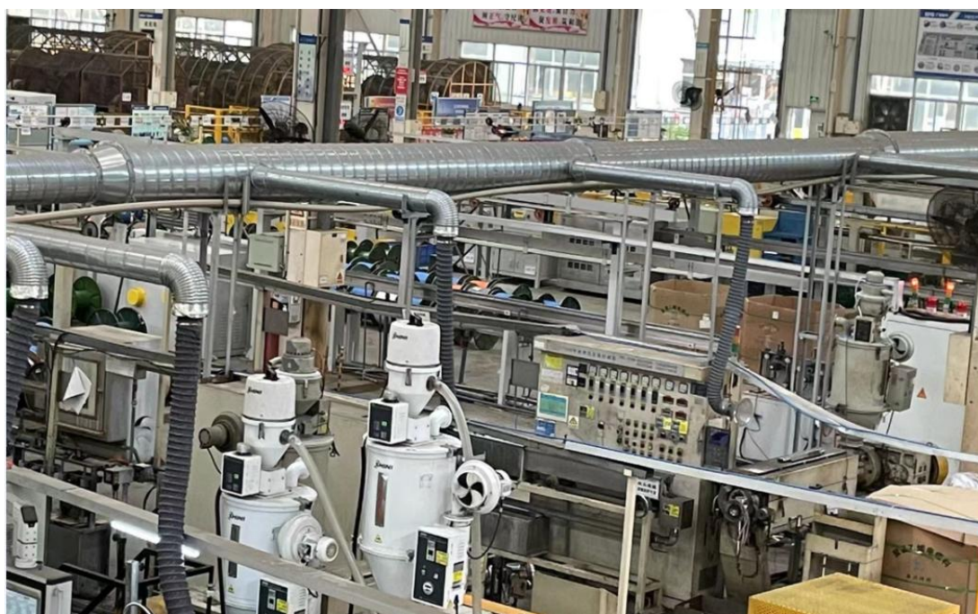
图 28 广日电气废气处理系统
